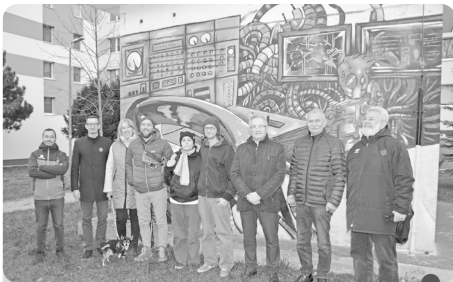
Domáci umelci prijali výzvu VSD, a. s., a zmenili podobu trafostanice na sídlisku Západ. Výsledok toho, ako vidia sprejeri dispečing distribučnej sústavy, potešil aj vedenie mesta a obyvateľov sídliska. Ide o prvú legálnu sprejerskú trafostanicu v meste, ďalším podobným projektom je distribučná spoločnosť otvorená (komunikacia@vsdas.sk).
