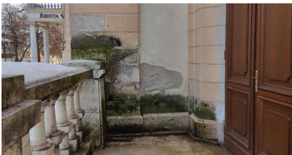
Dôsledok zmáčania z chrlíčov veže a pôsobenia odstrekujúcej vody.
