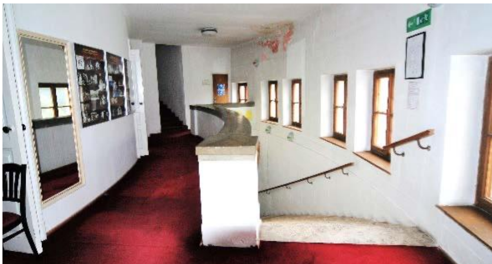
Poškodenie omietok v interiéri vplyvom zatekania strechy
