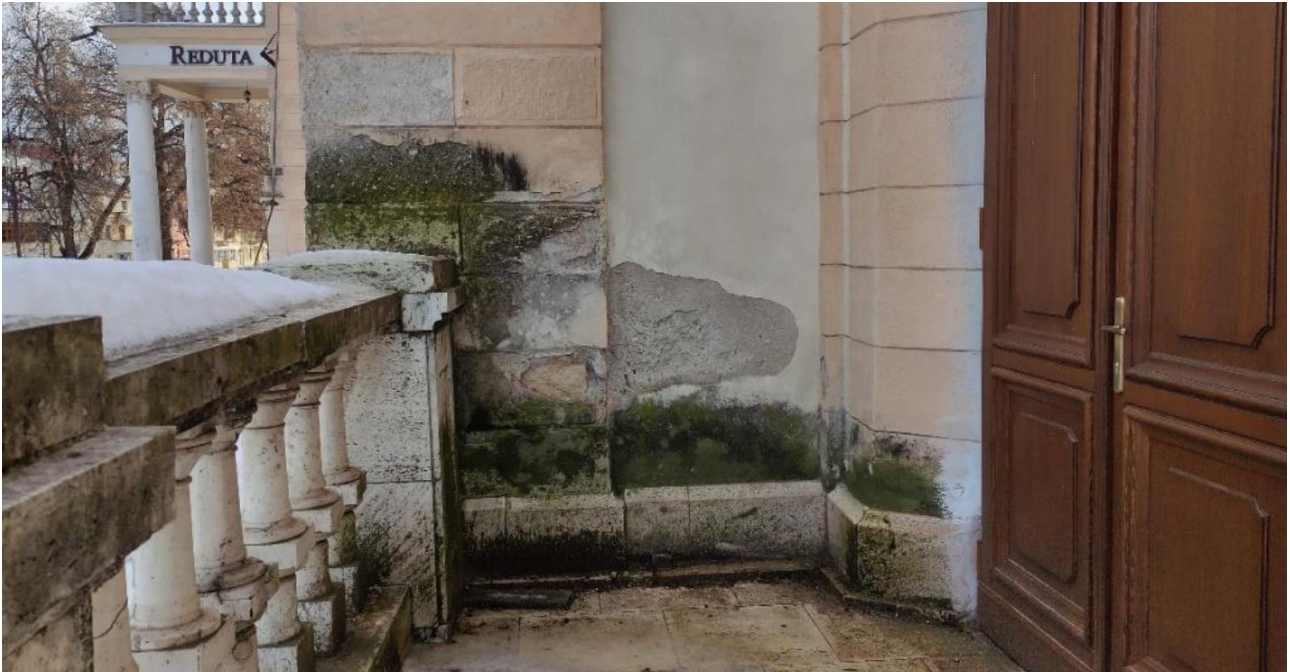
Dôsledok zmáčania z chrličov veže a pôsobenia odstrekujúcej vody.
